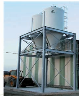
Silos polyester sur portique pour chargement
